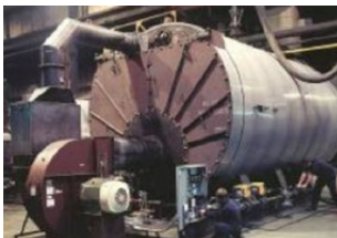
isolatie en afstandhouders in ketel en boilers
