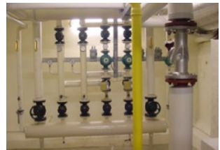
pakkingen tussen flenzen installatie
