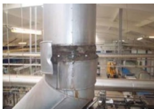
koordafdichting in kanalen (rookgas, wasem en gasafvoer). De isolatie onder de aluminium schalen kan ook asbest bevatten
