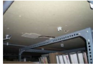
cementplaat met cellulosevezels als plafondblaat toegepast. Zacht materiaal
