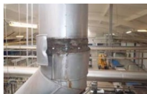
Asbest pakking in gasafvoerkanaal
