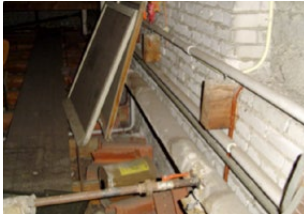
isolatie leidingen en vaten verwarming- of stoominstallatie
