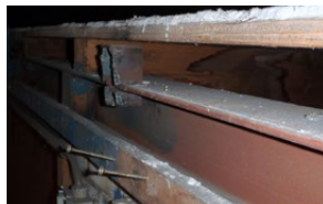
Beschadigd brandwerend materiaal
