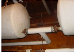
isolatie leidingen en vaten verwarming- of stoominstallatie
