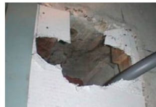
kabeldoorvoer / brandcompartimentering. Beplating heeft een honinggraat structuur
