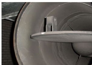
brandklep in (luchtbehandelings) kanalen
