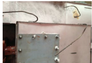
koordpakking ter afdichting van oven
