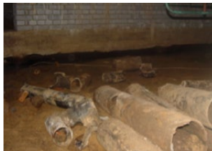
oude rioolleidingen in kruipruimte
