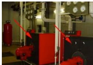
ketel die asbesthoudende onderdelen kan bevatten. De fundering van de ketel kan ook asbesthoudende beplating bevatten
