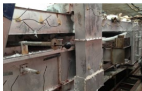
Asbest pakkingen in installatie
