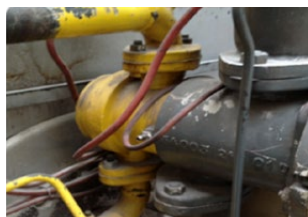
pakkingen in installatie (gasstraat)
